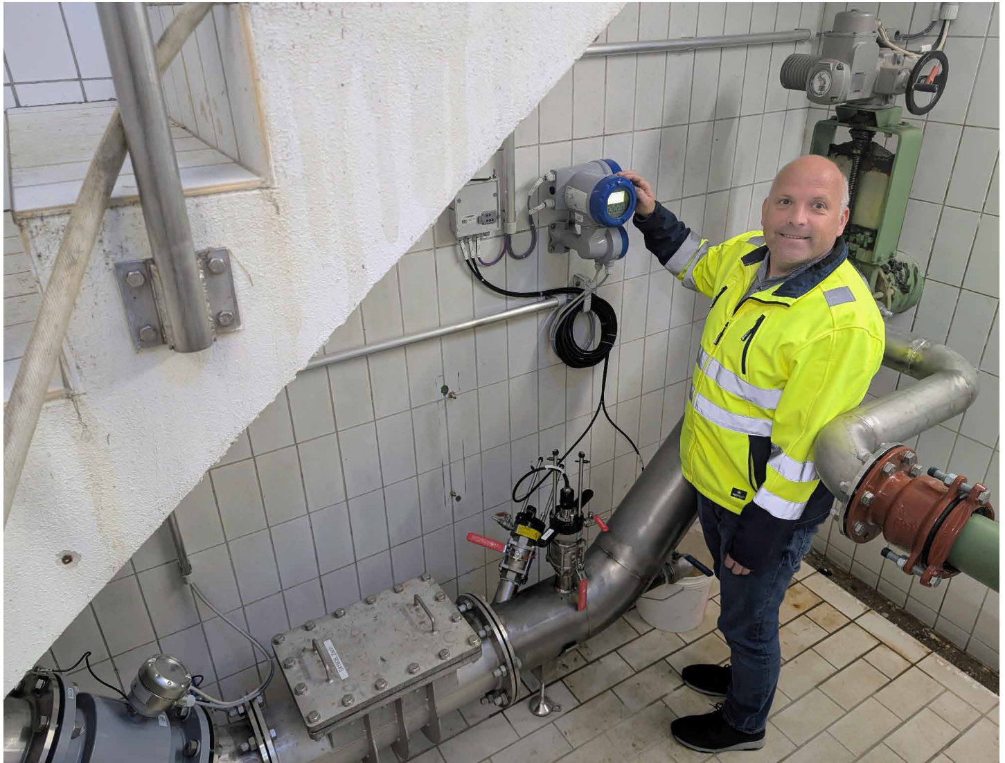
Bauamtsleiter Reiner Hundsberger an der neuen Messstation mit Probennehmer
