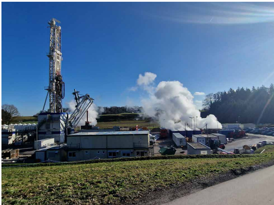
Geothermiebohrung Kirchweidach II Halsbach Waldweihnacht
